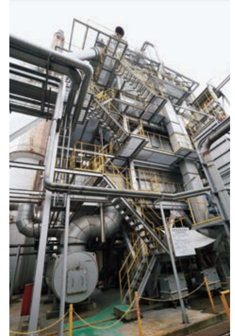
パイプ類が複雑に組み込まれたRPFボイラー
