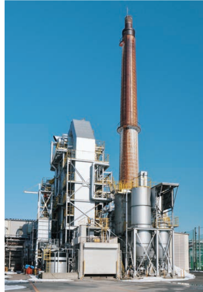
新幹線の関連工事に先駆けて、2009（平成21）年に導入したRPFボイラー。抄紙の過程で出るペーパースラッジや廃プラスチックなどを燃料とする徹底したリサイクルが特徴となっている
