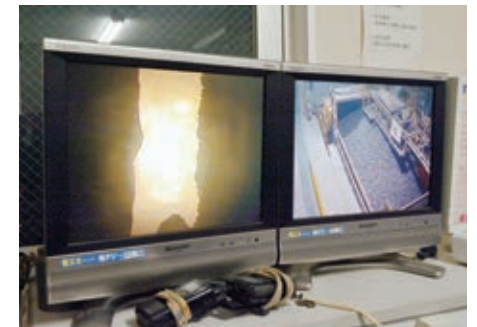
ボイラー内の燃焼状態をチェックするモニター
